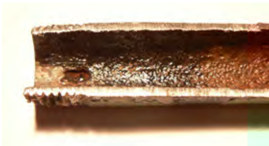
Hapen aiheuttamaa pistekorrosiota voi tulla uusiinkin putkiin.
